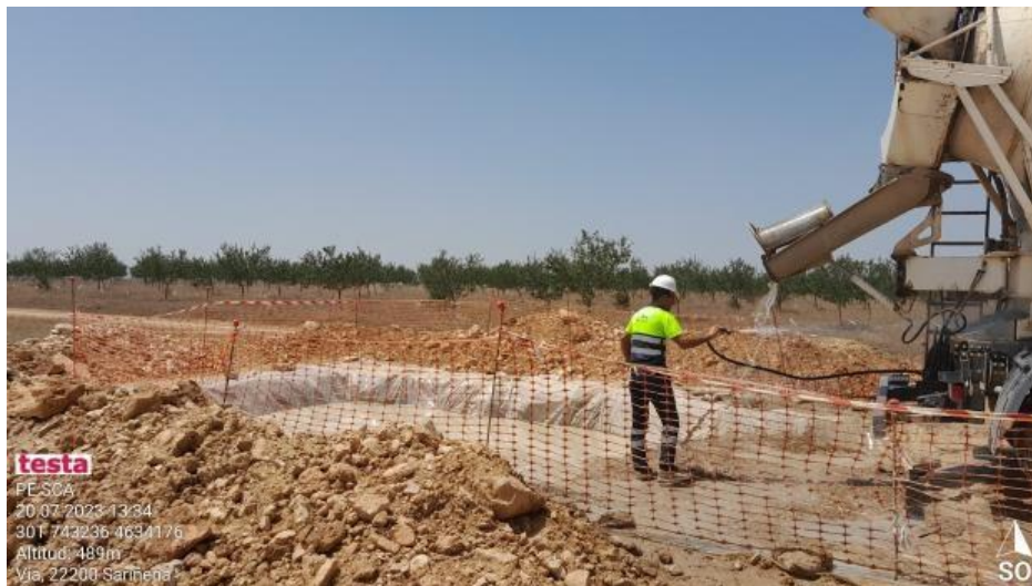
Pozo de lavado en SCA
