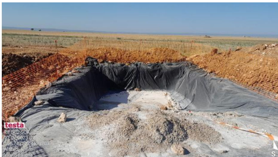
Pozo de lavado en SCA.
